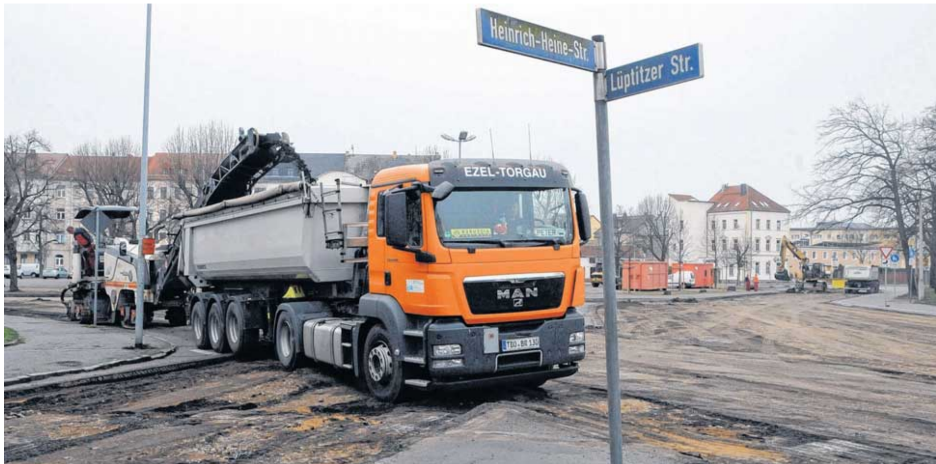
Baubeginn auf dem Bürgermeister-Schmidt-Platz: Seit Montagmorgen, 8 Uhr, sind die Nord- und Ostseite des Verkehrsknotenpunktes sowie der Kreuzungsbereich Lüptitzer-/Heinrich-Heine-Straße voll gesperrt. Die Baufirma hat gestern mit Abräumen des Fahrbahnbelages begonnen. Der pünktliche Start, so Manfred Bresk vom Bauamt, lasse hoffen,
